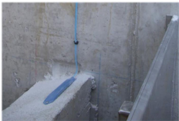
Ejemplo de instalación de la sonda F100 sobre un muro de alivio rectangular.
